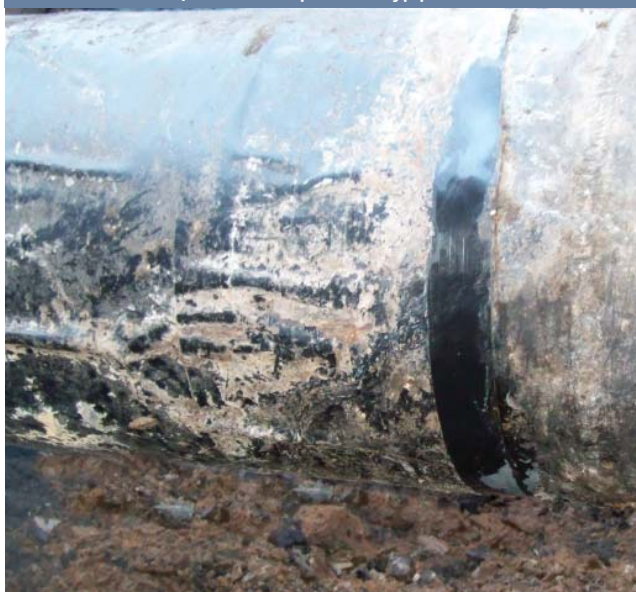
8 Состояние изоляционного покрытия в шурфах
